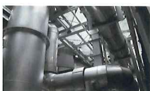
プラント配管
